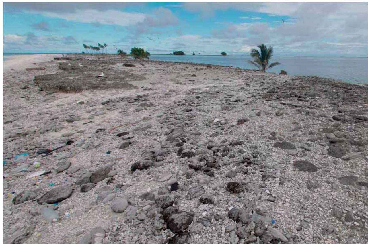
Figure 2-41. Vue au sol de la partie extérieure (côté océan) du point de mesure M1 qui montre un sol en dépression et raviné par le passage fréquent d'eau. Le trottoir est interrompu à cet endroit-là.
